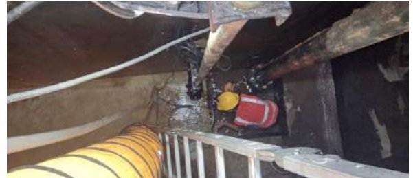
สภาพภายในถังหลังการเก็บเศษตะกอน
