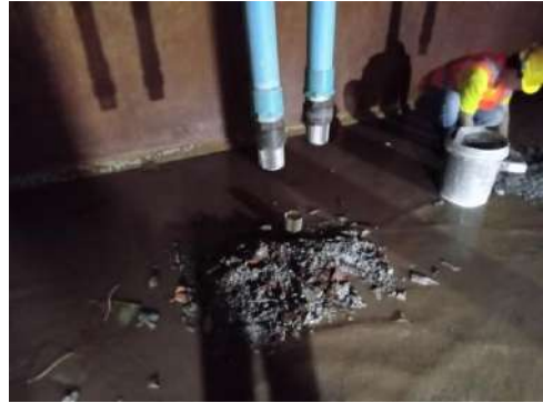
สภาพภายในถังและการดันตะกอนถังใน
